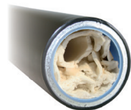
Peu hygiénique : conduite entartrée
