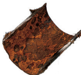
Peu hygiénique : conduite métallique corrodée
